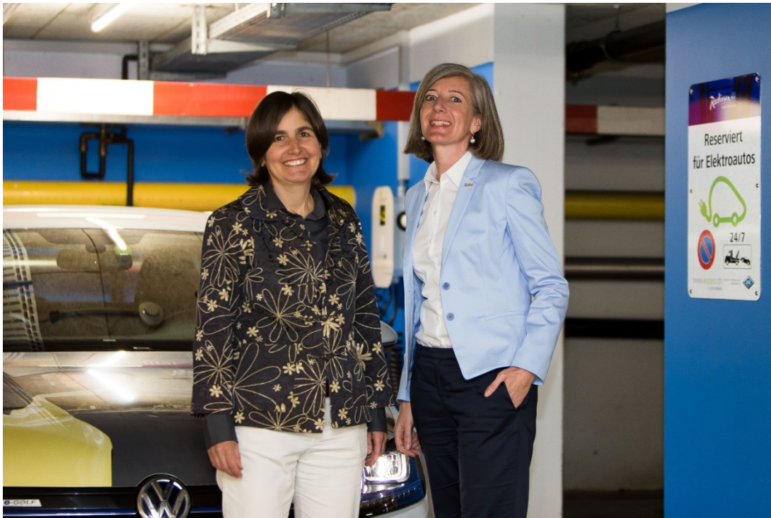
Freuen sich über die neu installierten Ladestationen: Tanja Schulte, General Manager Radisson Blu Hotel St.Gallen (rechts im Bild) und Alexandra Asfour, SAK Projektleiterin E-Mobilität.
